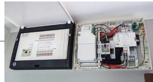
通常分電盤（左）の右に設置した重要負荷分電盤
