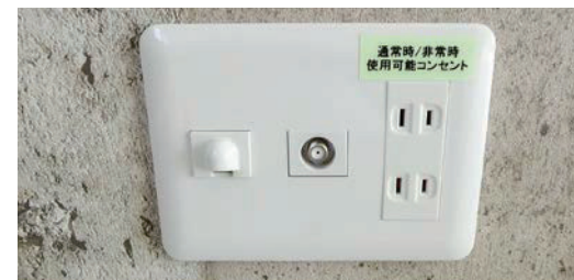
室内の非常時使用コンセント
