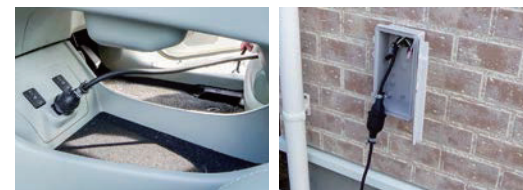
外壁に設置した屋外電源入力 BOX とハイブリッド車を電源コードでつなぐ
